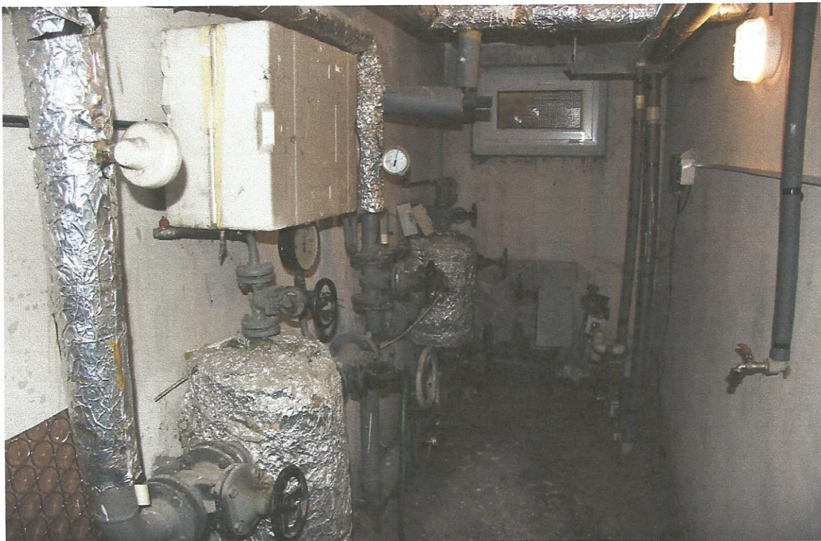
Objektová předávací stanice
