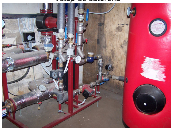
Výměňníková stanice, akumulace TV
