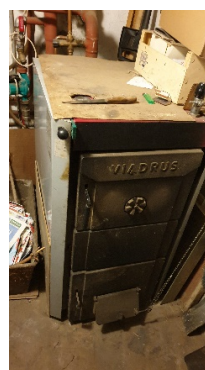
Stacionární kotel na TP
